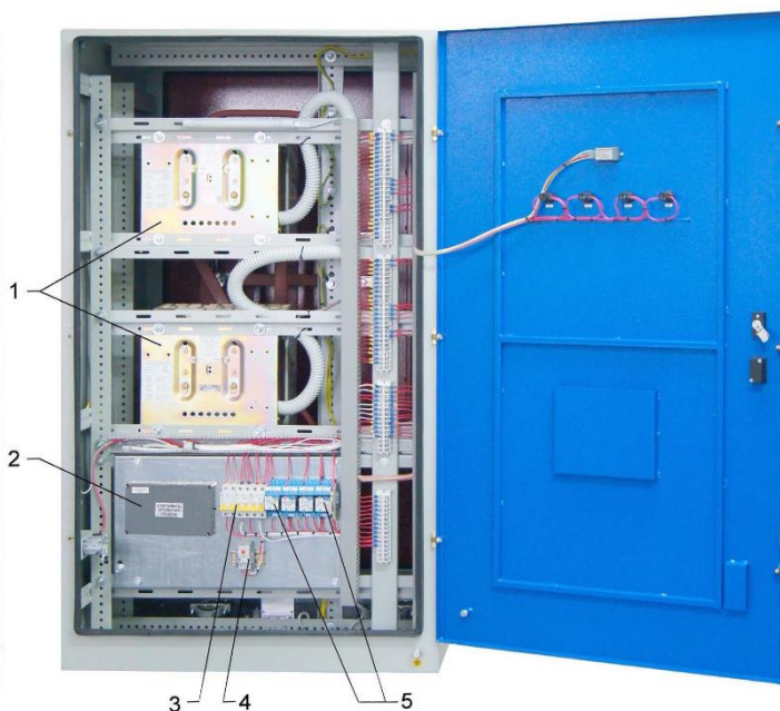
Рис. 2 Шкаф КРУ-РН-6-ВК-2-400 Вид спереди с открытой дверью
