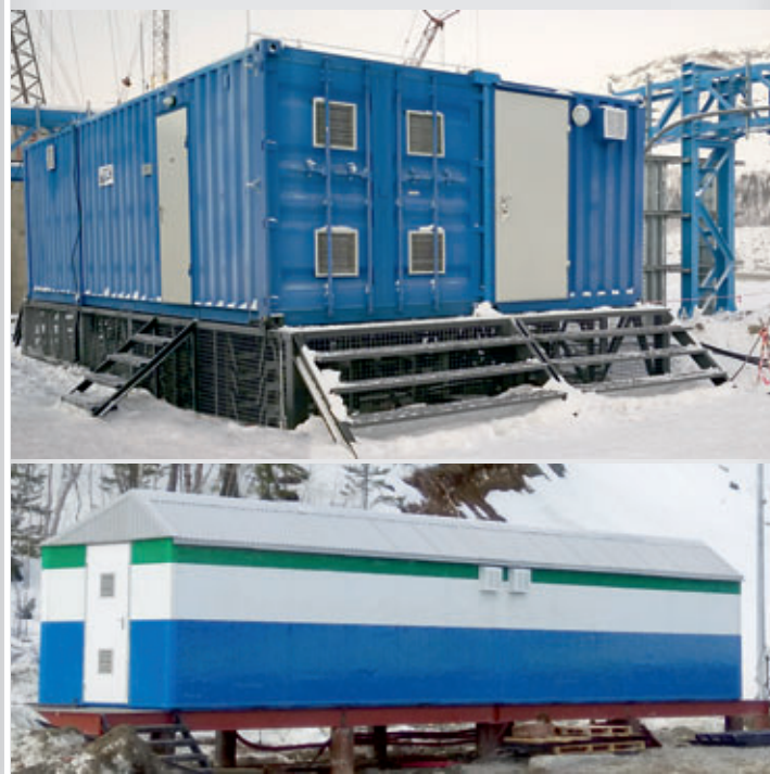
Карьерные распределительные пункты КРП напряжением до 10кВ
