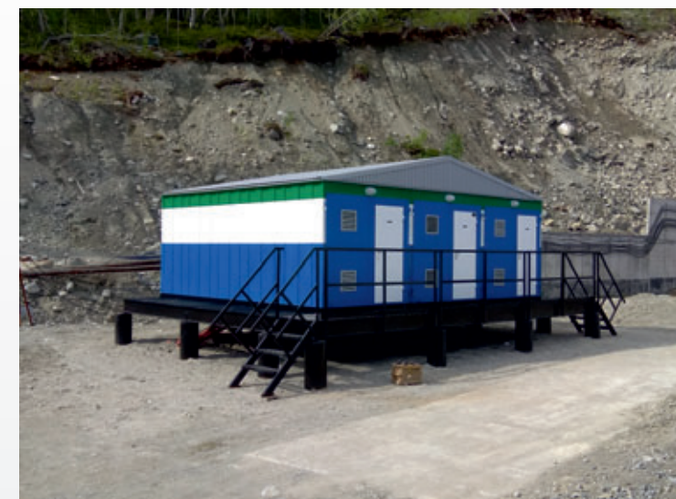
Трансформаторная подстанция 2х630кВА ( Юкспорский тоннель №2 ОАО "Апатит")
