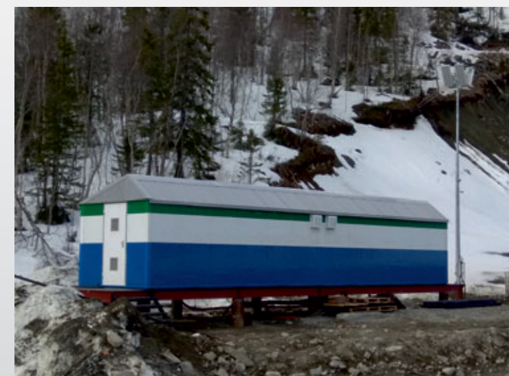
Распределительное устройство 6кВ ( Юкспорский тоннель №2 ОАО "Апатит")
