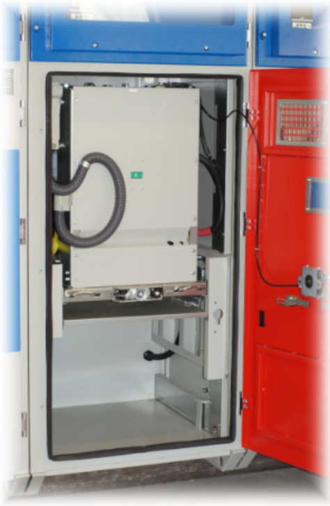
Отсек секционного выключателя
