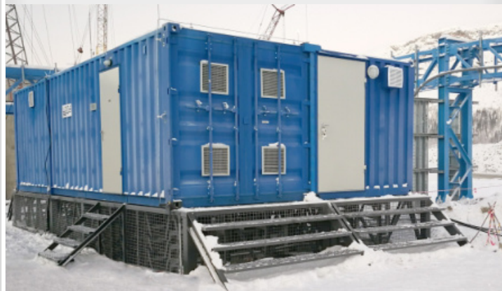
Карьерные распределительные пункты КРП напряжением до 10кВ
